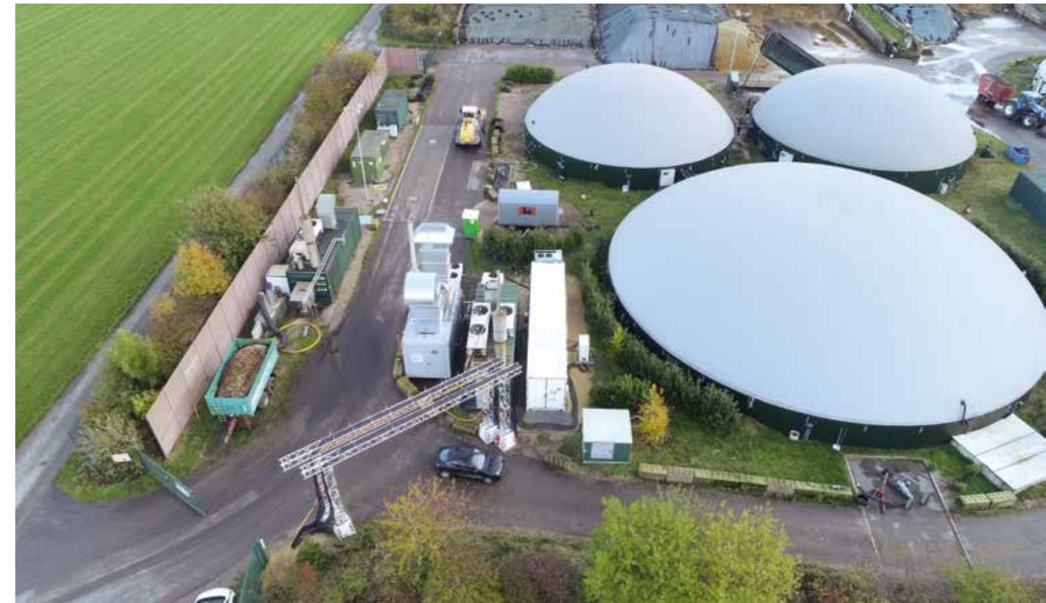
In Gangelst-Birgden unternahm das Quirinus-Projekt erfolgreich Netzsimulationen mit einer örtlichen Biogasanlage, einem gasbetriebenen Blockheizkraftwerk und einem Schwungradspeicher.
