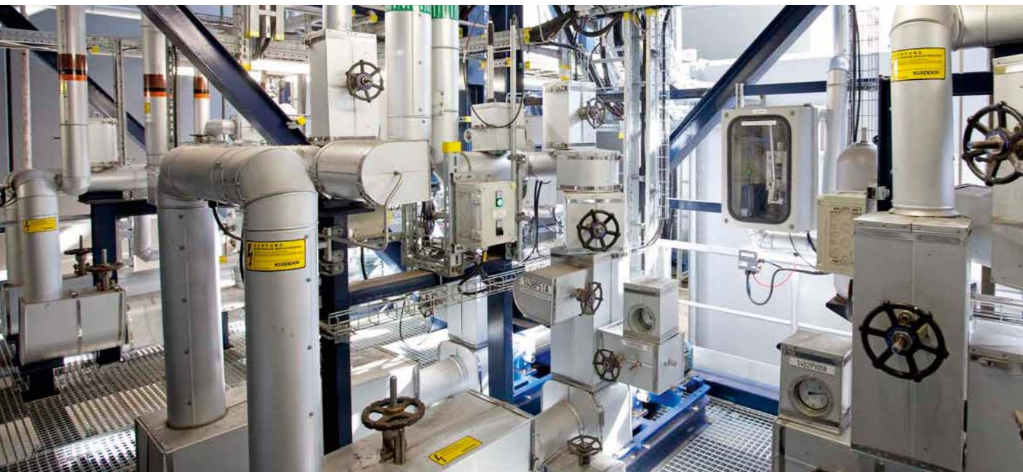
Die Pilotanlage wäscht seit 2009 mit großem Erfolg für Wissenschaft und Verfahrenstechnik CO 2 aus einem Teilstrom des Rauchgases von Block K.
