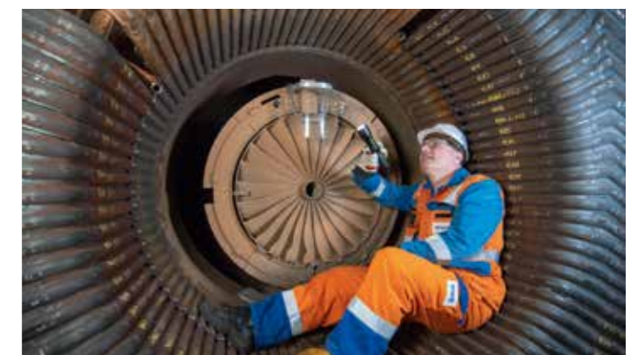
Strömungsoptimierte Innenquerschnitte mindern den Verschleiß am Brenner eines Dampferzeugers während der Revision.
