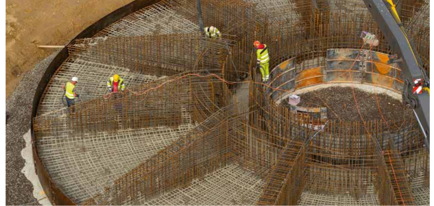
Die sechs neuen Windkraftanlagen des Kooperationswindparks Jüchen an der A 44n werden Strom für bis zu 26.000 Haushalte erzeugen. Jede von ihnen wird über 200 Meter hoch: Betonage der Fundamente.
